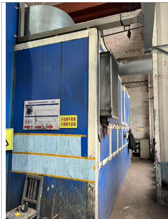
喷漆废气处理设施
