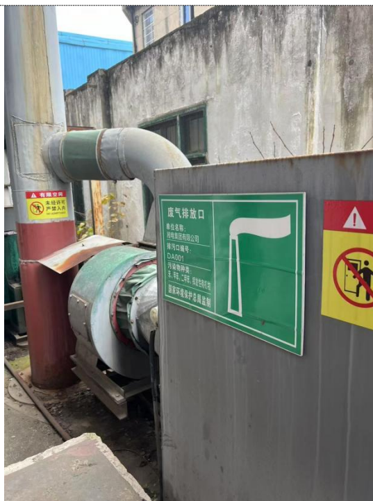
浸漆废气处理设施
